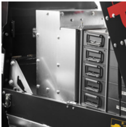
21 kWh La batterie au lithium (Li-ion, 65VDC, NMC)
